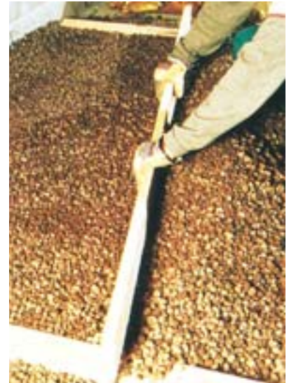
Réalisation d'une couche isolante en argile expansée pour la sous-couche d'une chape flottante.
