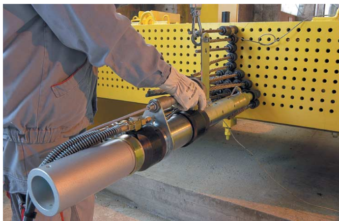
Mise en tension des armatures de précontrainte. Vue d'ensemble du peigne d'about permettant le positionnement des torons.
